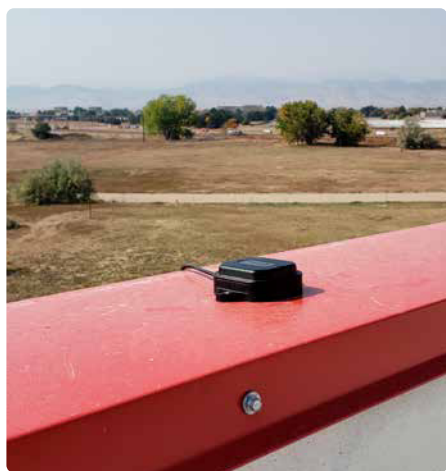
Figure 1. L'antenne U-blox fixée au parapet de SparkFun.
