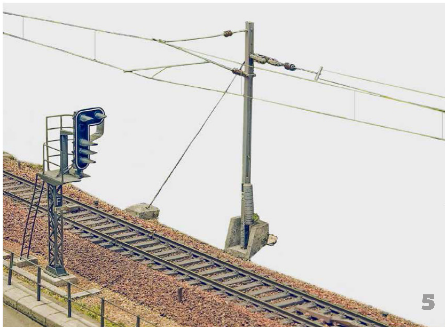
5: Ensemble tendeur monté (réseau de la Bosse, photo CFFC).
