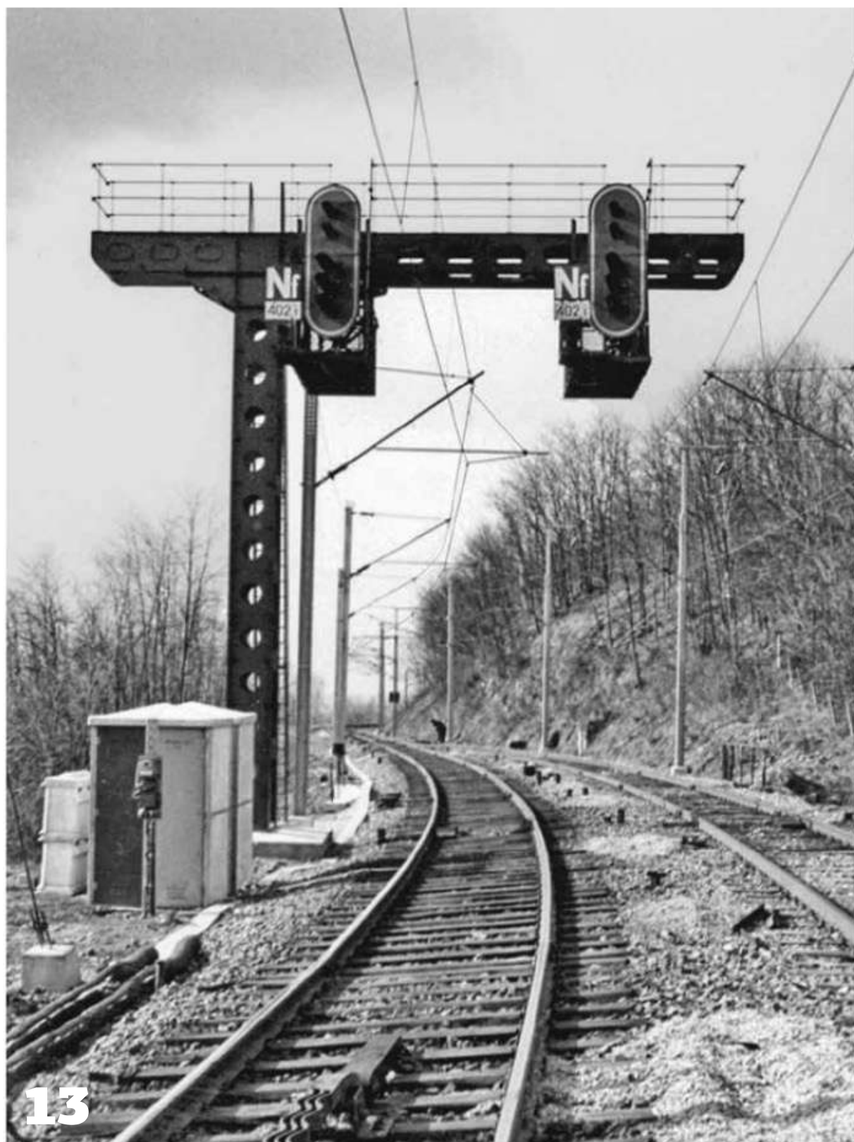
13: Sous un portique, la caténaire passe entre les nacelles.
